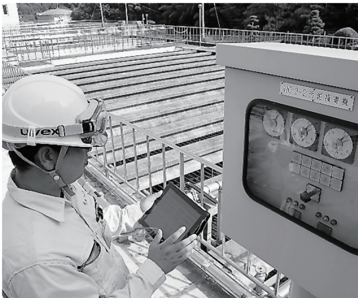
「水みらい広島」の社員が浄水場を点検しながら、携帯情報端末で状況を入力する。広島県大竹市の三ツ石浄水場
