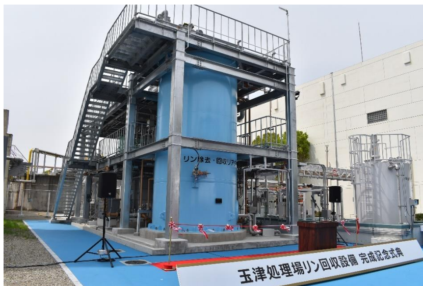
玉津処理場に設置したリン回収設備
