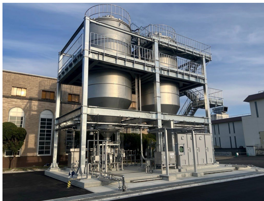
写真：ドライ粉末活性炭注入設備 カーボジェット®
