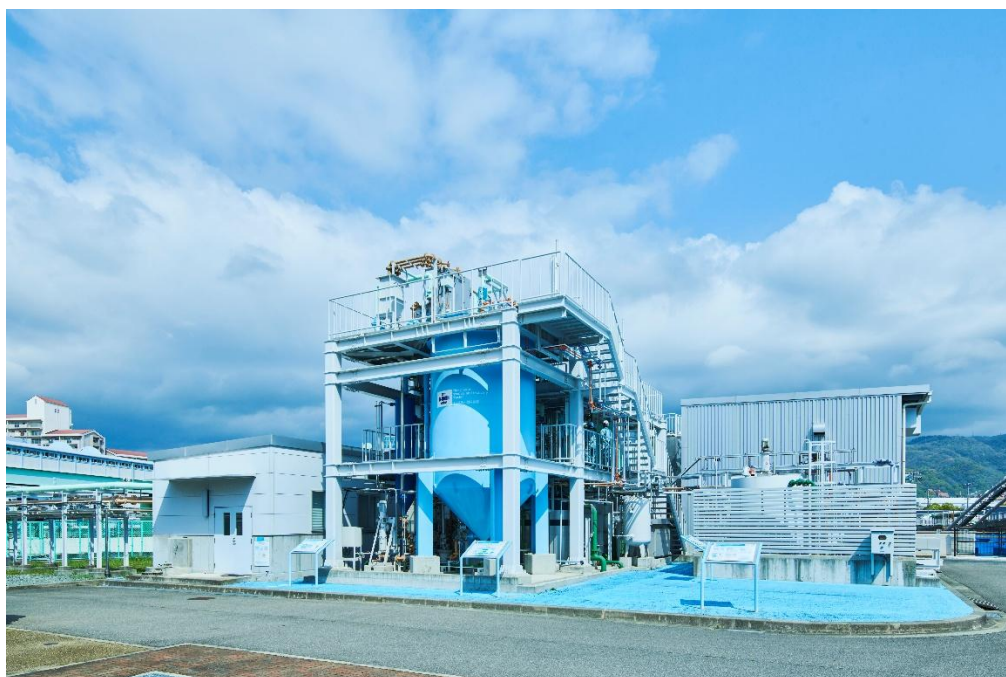
東灘処理場リン回収設備 現況写真
